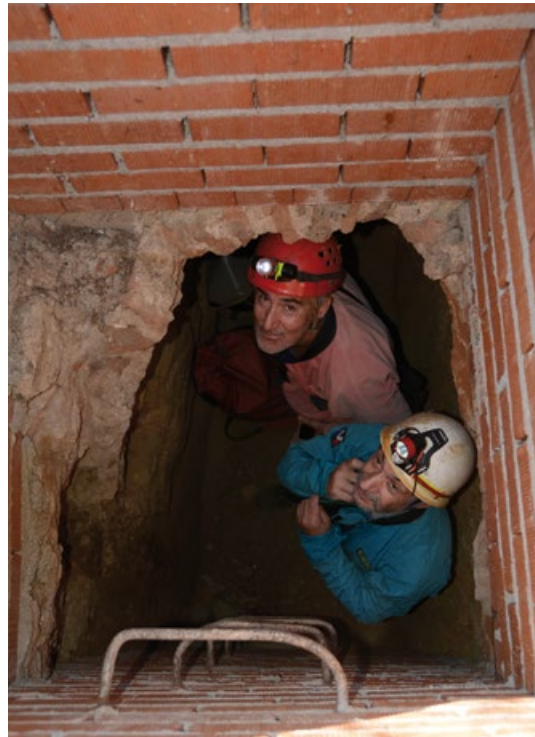
Brocal del pozo de entrada actual. La obra rompió el techo de la galería original del Encañado.
